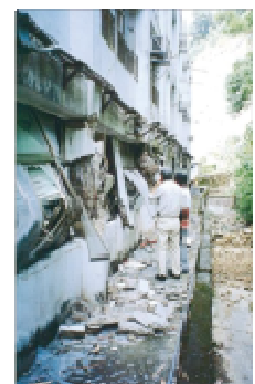
地震により倒壊した校舎
