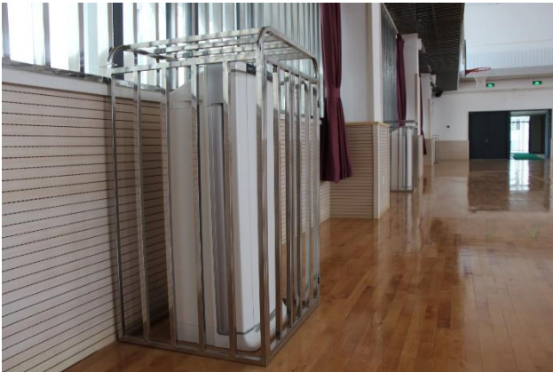
【大型空気清浄機（廊下・体育館）】
